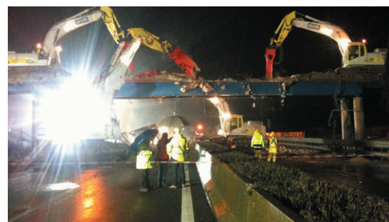
■ La demolizione del cavalcavia sulla A14 in località Marotta, a nove chilometri da Fano, da parte della Vitali Spa. L'impresa di Cisano Bergamasco è specializzata in sviluppo immobiliare, infrastrutture e demolizioni
